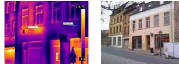
Abb. 50 IR-Aufnahme Sangerhäuser Straße 35 Front
