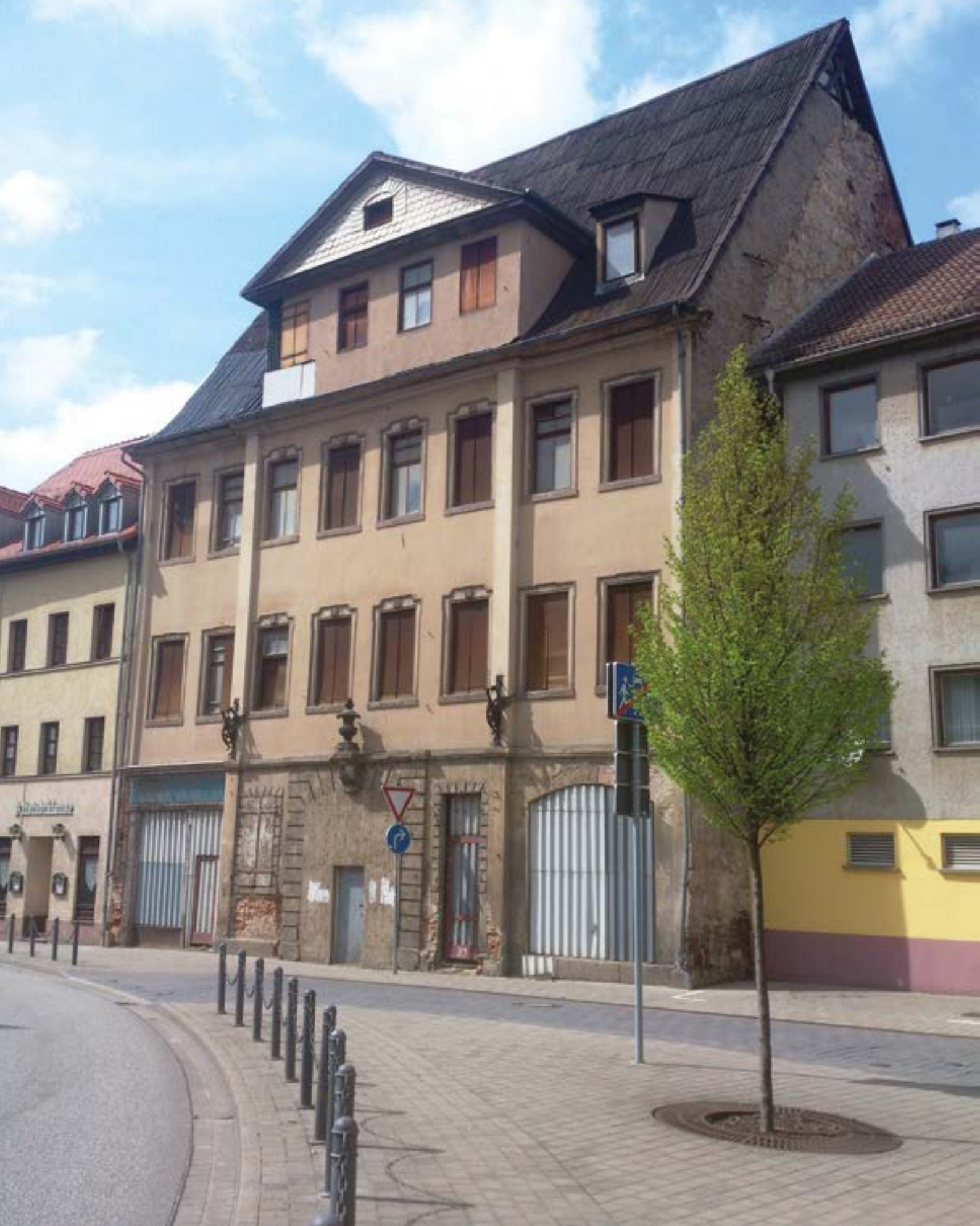
Abb. 1: Zustand des Hofmarschallhauses von der Straßenseite (Foto: Stadt Weißenfels)
