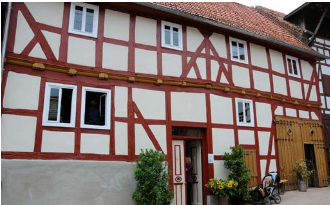
Abb. 6: Gebäude in Sachsenberg (Lichtenfels) nach Abschluss der Sanierung (Foto: Landesamt für Denkmalpflege Hessen)
