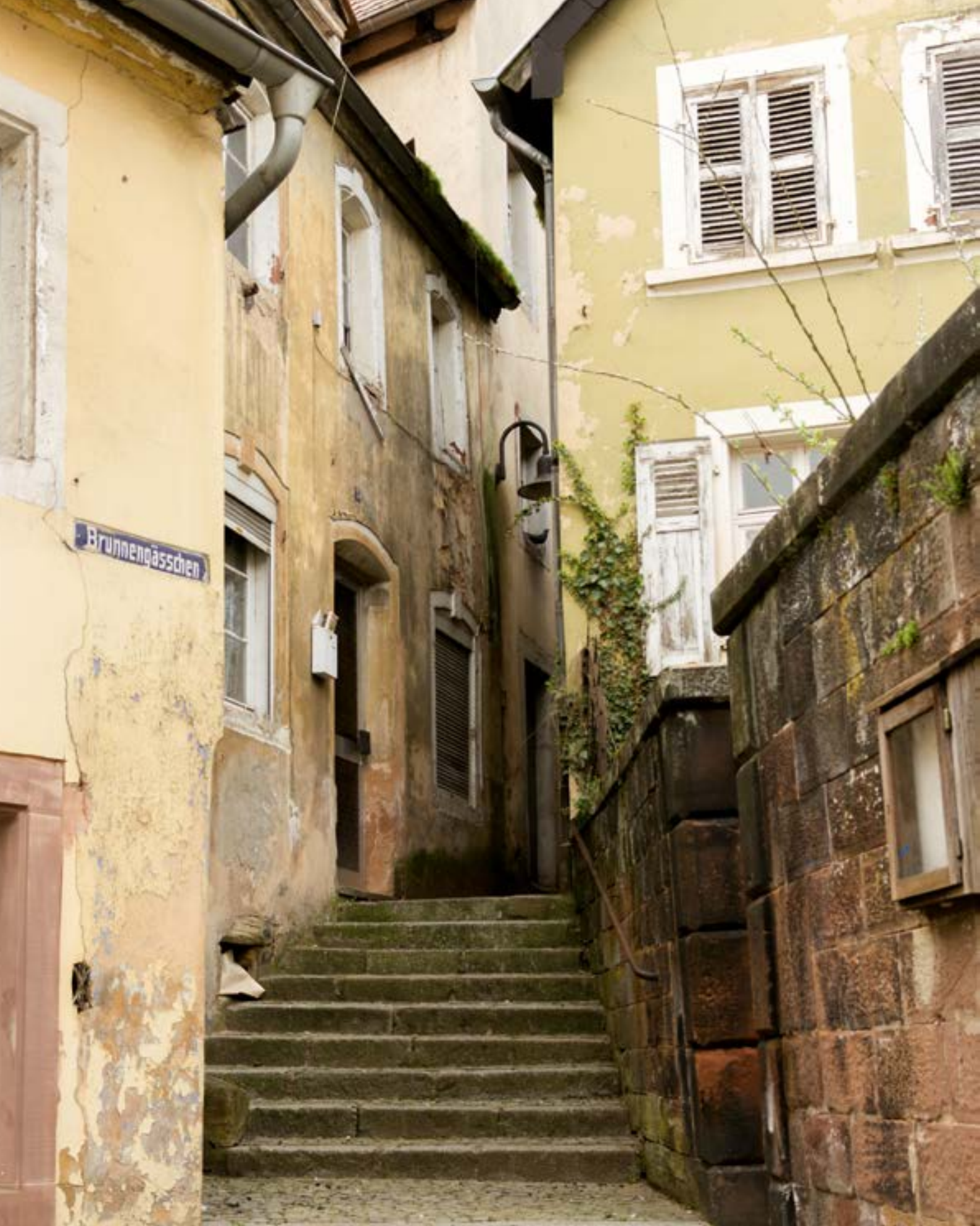
Abb. 1: Sanierungsbedarf (Foto: Stadt Blieskastel)
