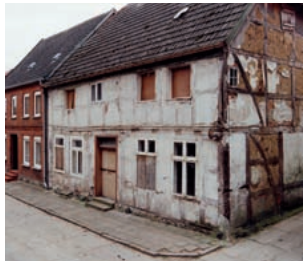
Abb. 15 | Zustand vor der denkmalpflegerischen Behandlung
