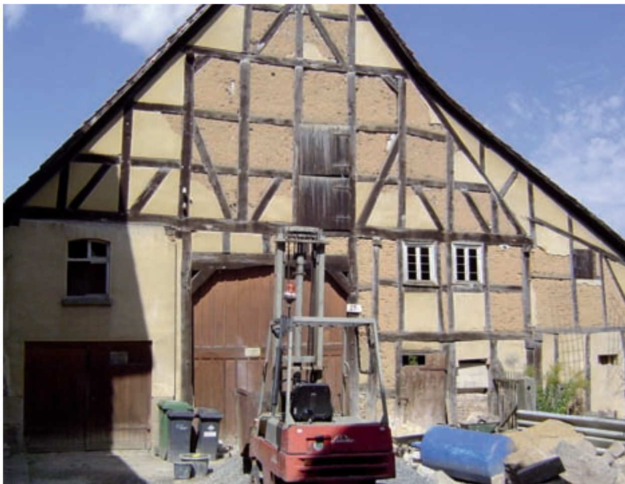
Abb. 6 | Wolfhagen, gefährdete Substanz
