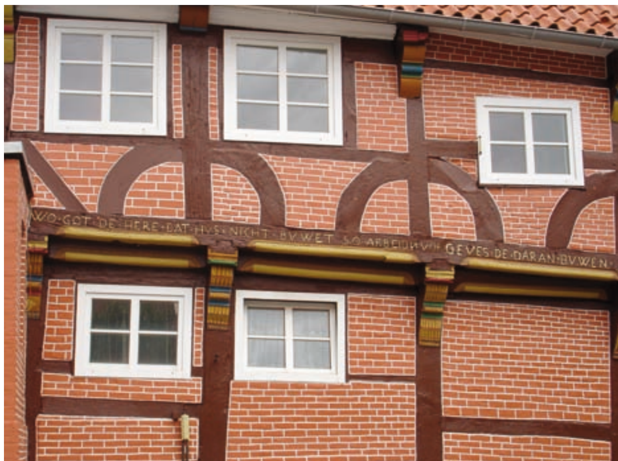
Abb. 2 | Gut gedämmte neuartige Fenster – aber keine akzeptable Lösung bei diesem Fachwerkbau
