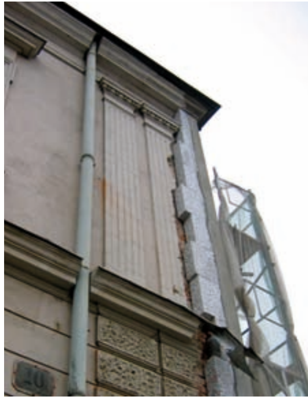
Abb. 8 | Sant Pölten Zerstörung durch Dämmungen
