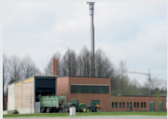
Umgerüstetes Blockheizkraftwerk auf dem Kasernenareal
