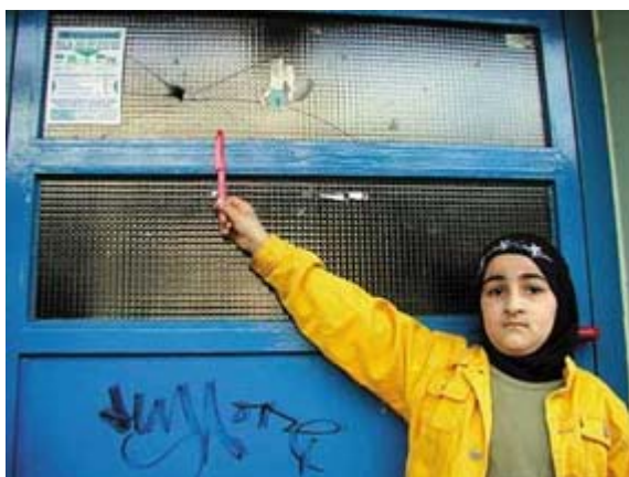
Zerstörte Eingangstüren - das stört auch die Kinder.
